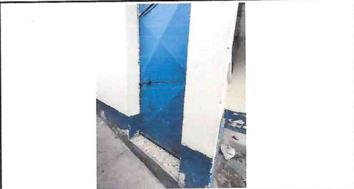
Foto 9: puertas en mal estado
