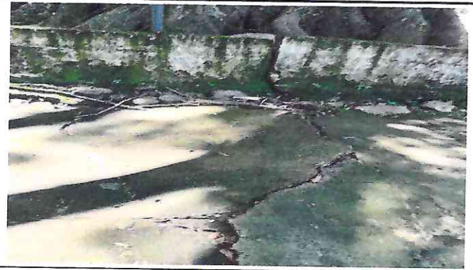
Foto 2: Muro perimetral en mal estado
