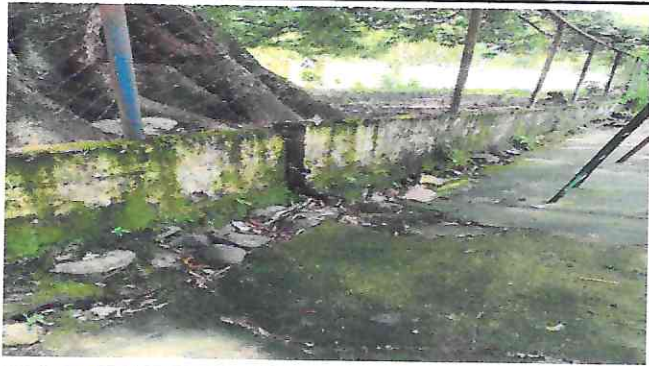
Foto 3: Muro perimetral en mal estado
