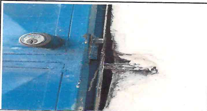
Foto 5: Puerta en mal estado
